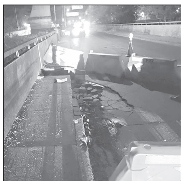
DETERIORO. El viaducto que une a la Argentina y Brasil.
